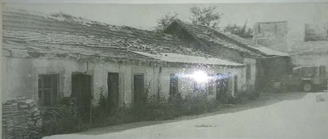
3. Помещение, где размещались личный состав отряда и административных работников отряда (до строительства нового пожарного депо).
